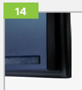
Okapnik (drzwi otwierane do wewnątrz)
